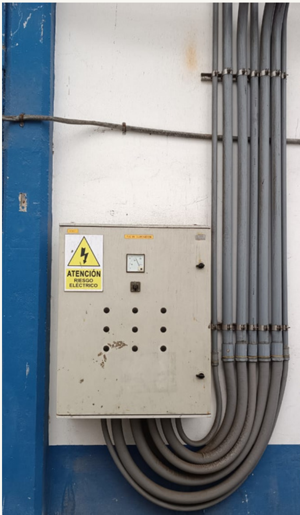
Cableado estructurado con tubería PVC.
