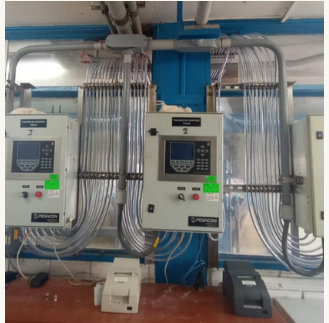
Cableado estructurado especiales.
