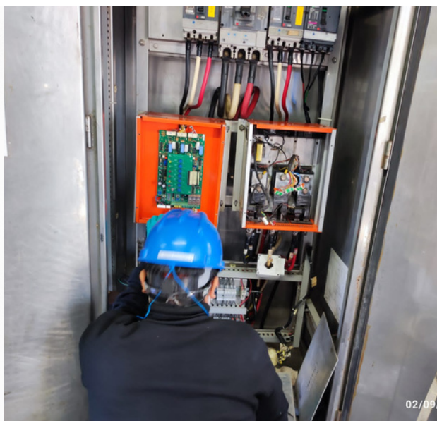
Mantenimiento de arrancadores electrónicos.
