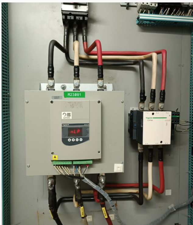
Diseño e instalación de tableros con arrancadores.
