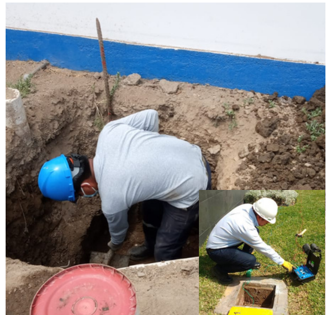
Diseño, mantenimiento y medición de pozos a tierra.
