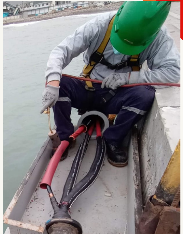
Empalme de cables de media tensión.
