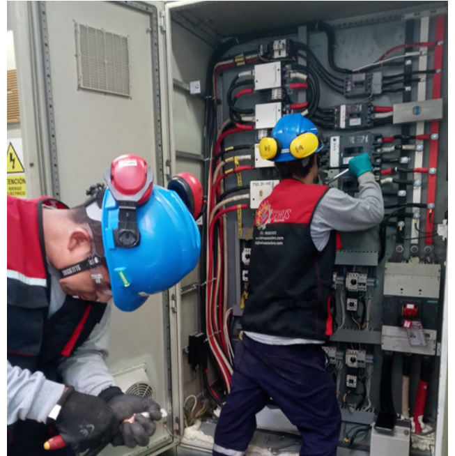
Instalaciones eléctricas industriales.
