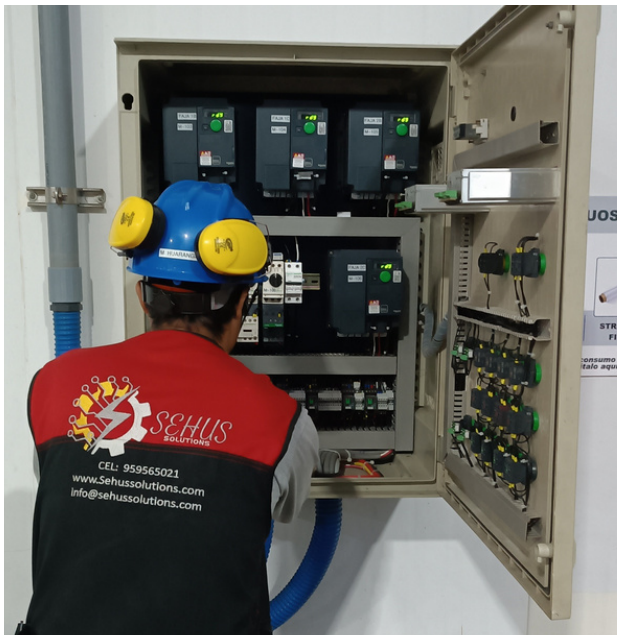
Diseño e instalación de tableros con variador de frecuencia.
