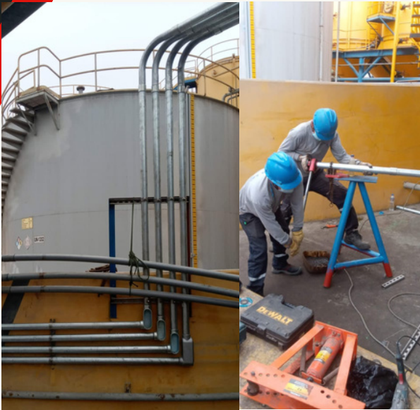
Cableado estructurado con tubería conduit.
